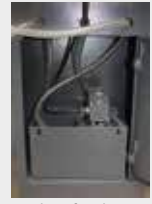
Pompe de refroidissement
